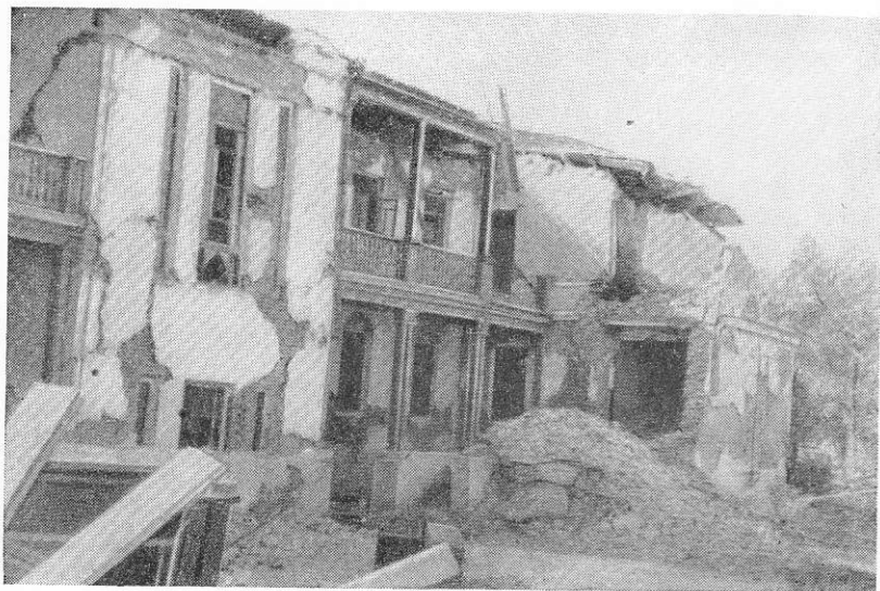
Рис. 120. Разрушение стен, выходящих во двор
