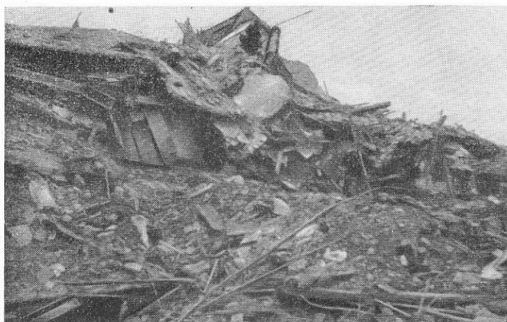
Рис. 170. Разрушенное здание холодильника
