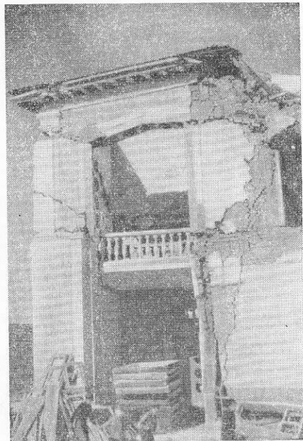
Рис. 63. Повреждение угловых лоджий и срез боковых пилонов
