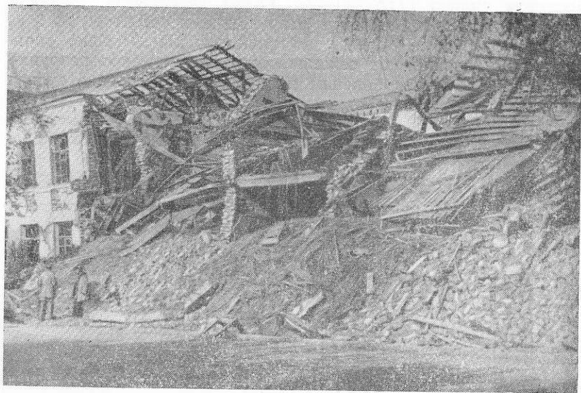
Рис. 73. Разрушения центральной части здания
