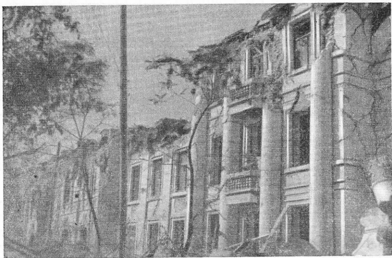
Рис. 228. Разрушение тяжелых парапетов
