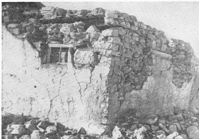
Рис. 193. Расслоение кладки из естественного камня
