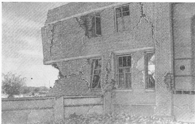
Рис. 103. Разрушение угла и простенков здания
