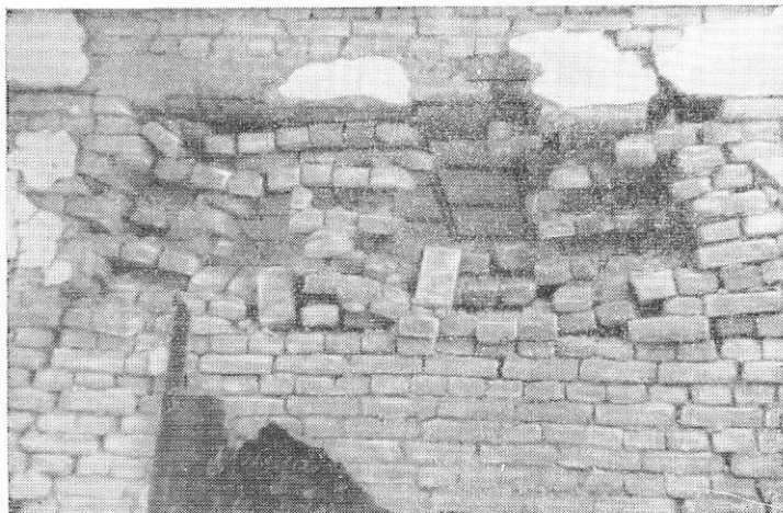
Рис. 218. Расслоение кирпичной кладки внутренней стены
