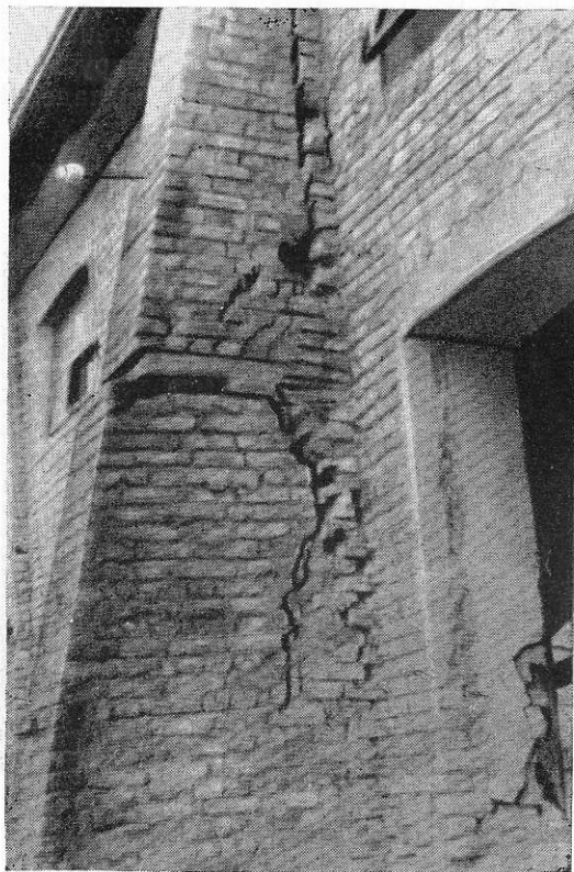
Рис. 164. Повреждение односторонних контрфорсов
