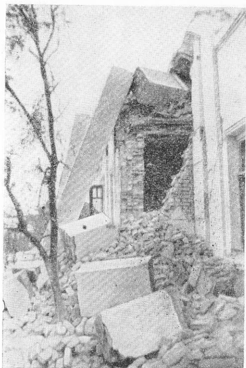
Рис. 234. Разрушение кирпичного портика школы
