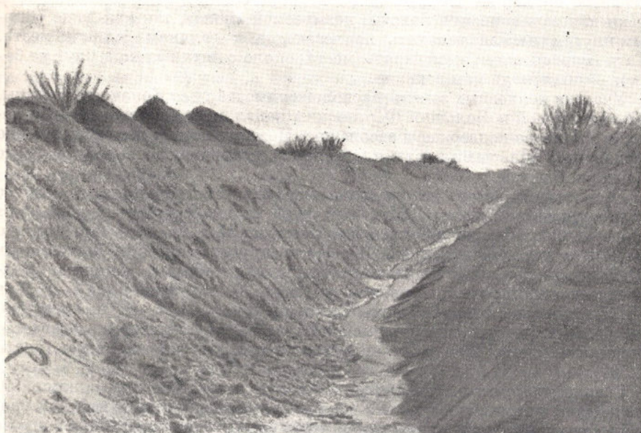
Рис. 13. Коллектор для отвода грунтовых вод.
