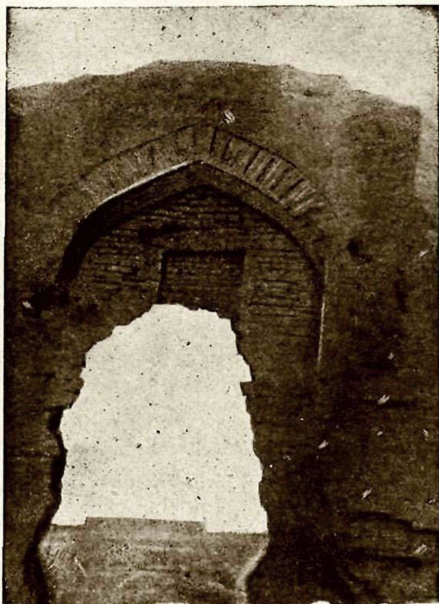
Рис. 18. Пролет в стене здания № 12.
