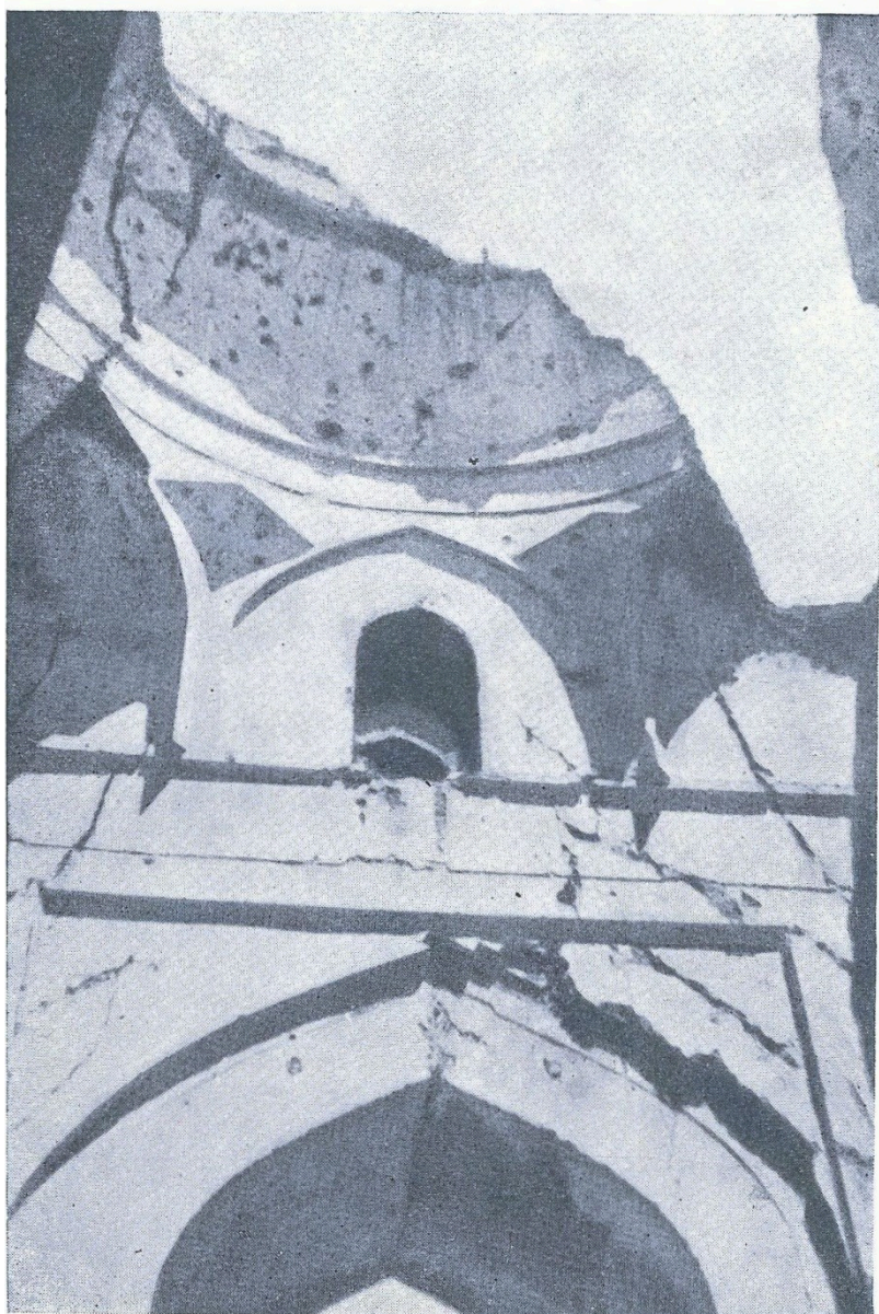
Рис. 34. Деформация парусов и свода.
