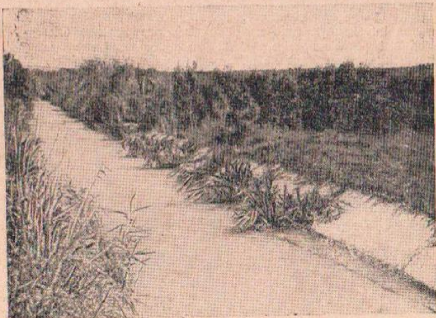
Рис. 61. Прорастание растительности на канале, облицованном плитами.
