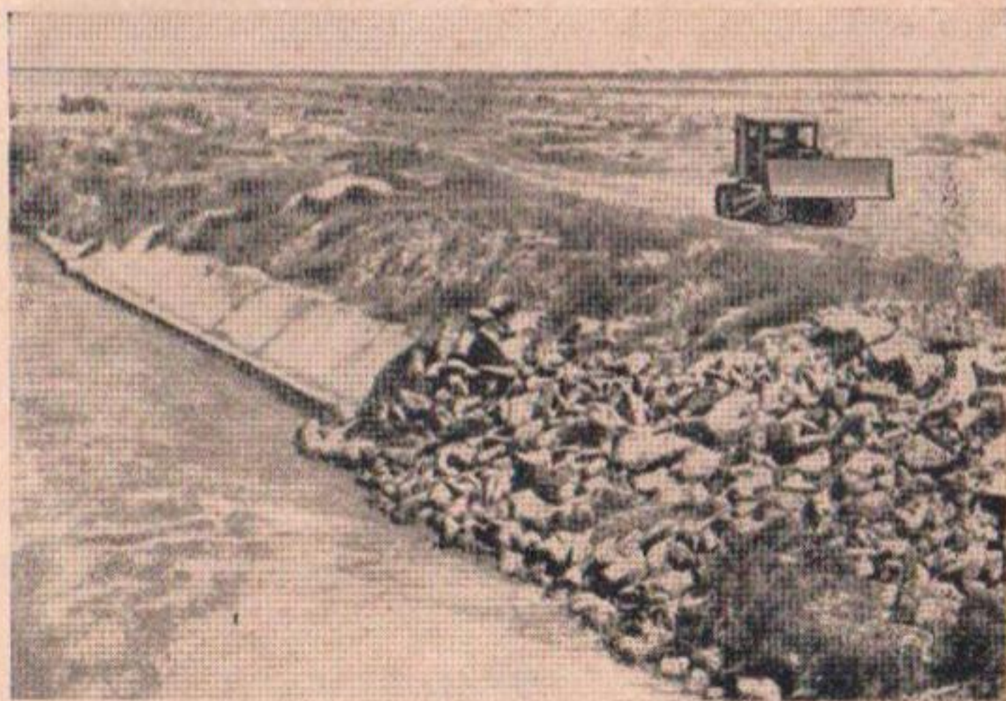
Рис. 62. Крепление деформированного русла облицованного канала каменной отмосткой.
