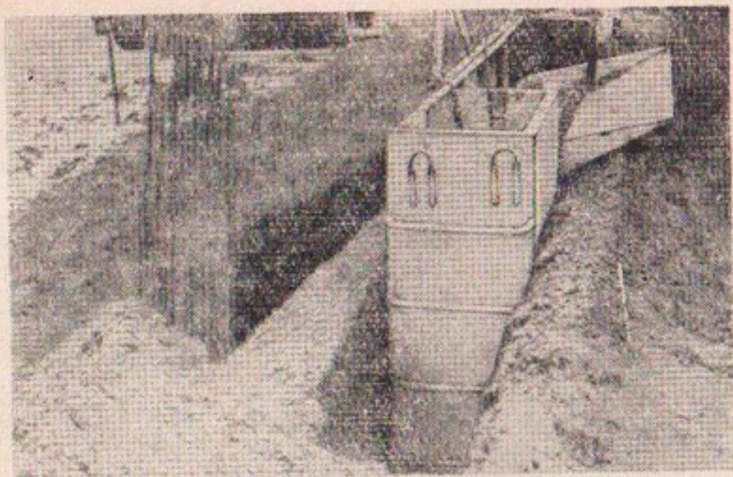
Рис. 3. Характер обрушения стенок при работе Д-659А с засыпающим транспортером.
