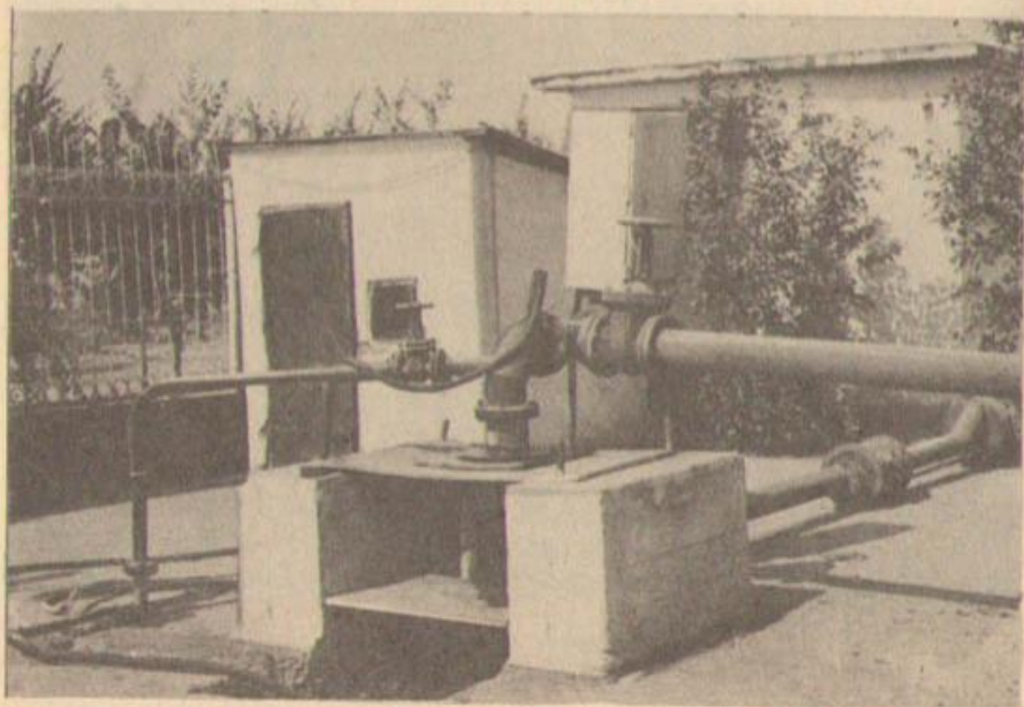
Оборудованная скважина для орошения в Калининском районе.
