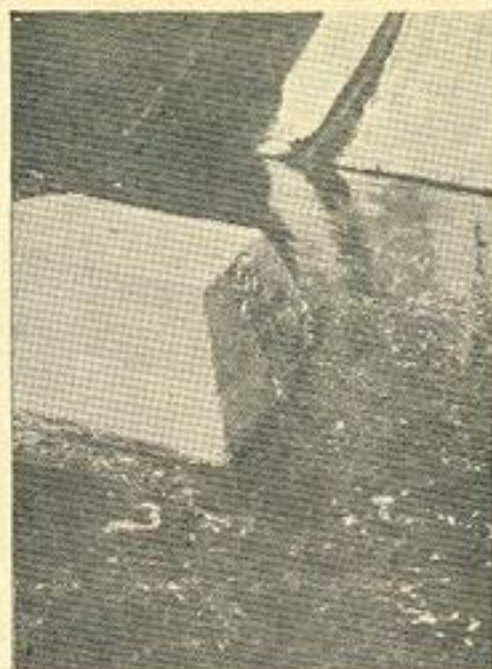
Рис. 27. Кавитационное разрушение на шашке-гасителе водосливной плотины Волжской ГЭС им. В. И. Ленина.
