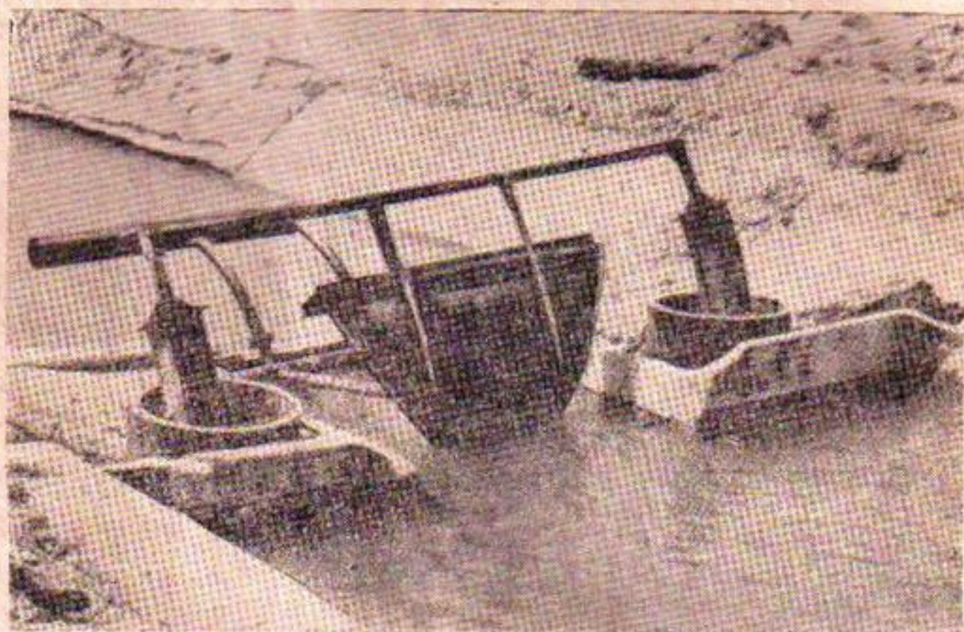
Рис. 6. Затвор-автомат верхнего бьефа с поплавками в колодце на распределителе совхоза 5 в Голодной степи.
