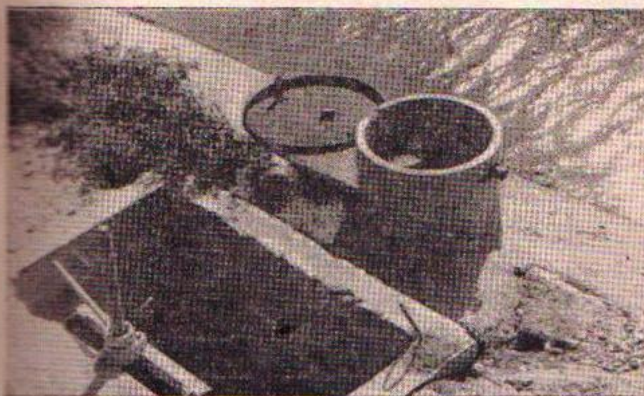
Рис. 7. Водомерный колодец с прибором на сооружении.
