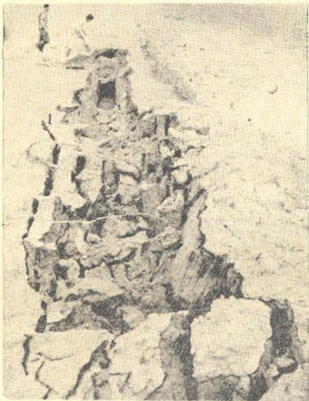
Рис. 1. Разрушение закрытой дрены поверхностной водой.
