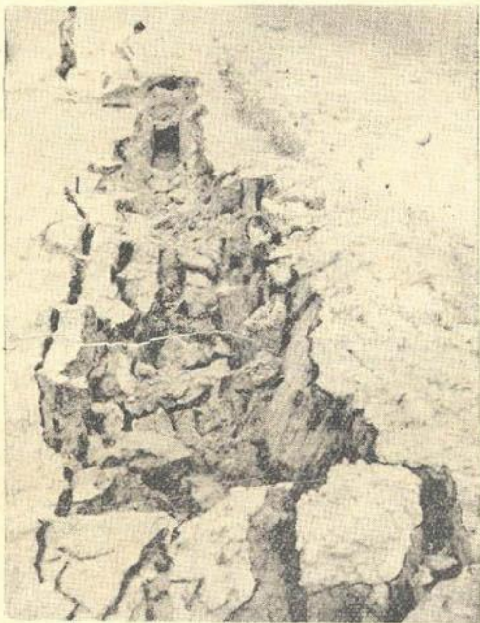
Рис. 1. Разрушение закрытой дрены поверхностной водой.
