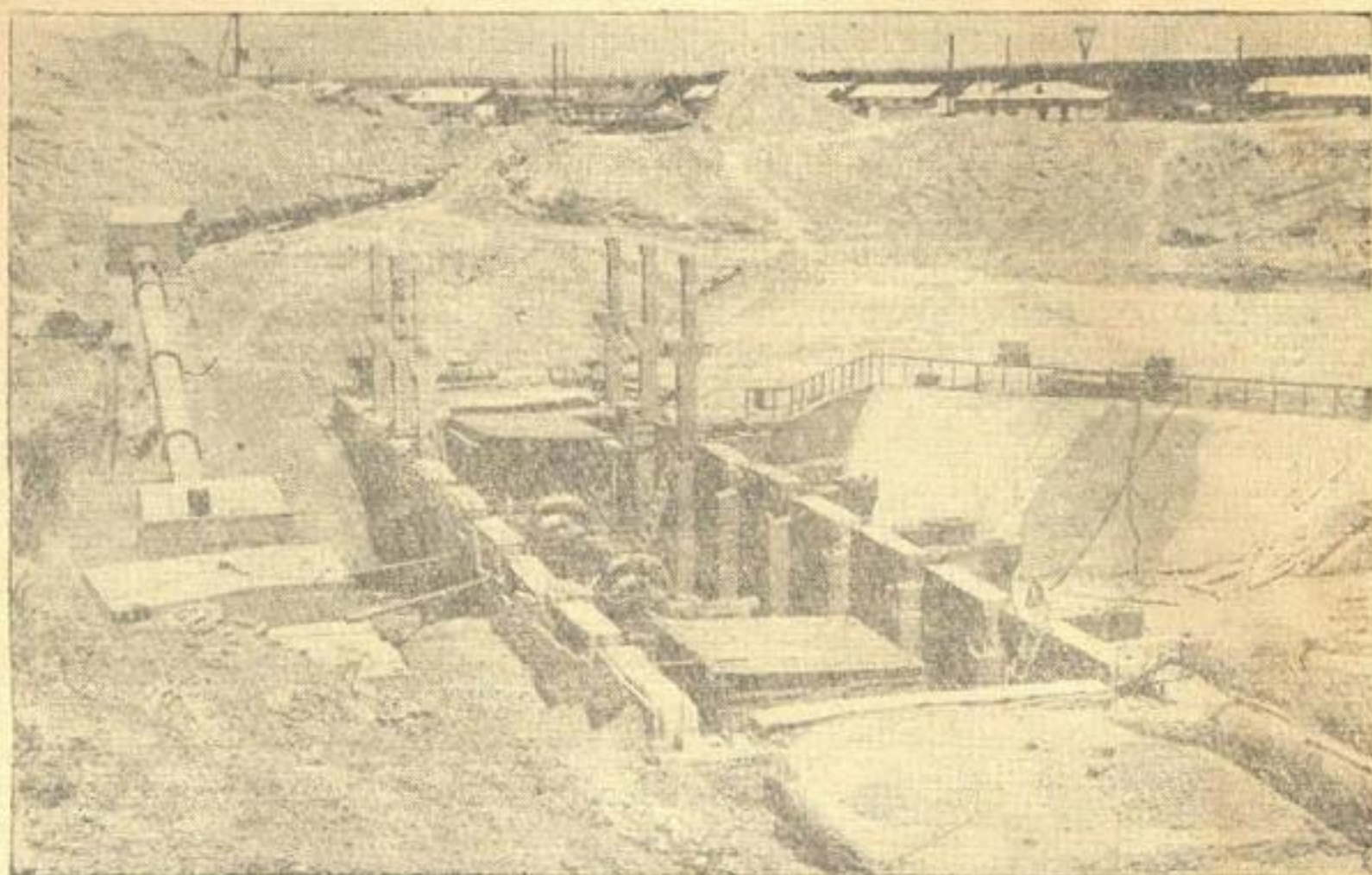
Рис. 6. Мощная четырехагрегатная Баяутская насосная станция (см. рис. 1). Виден напорный трубопровод первой ступени водоподачи (29 июня 1958 г.).
