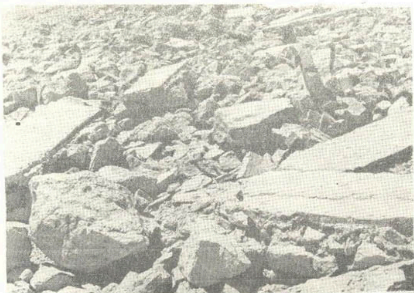
Рис. 1. Каттакурганское водохранилище; вид разрушенного каменного крепления откоса плотины.
