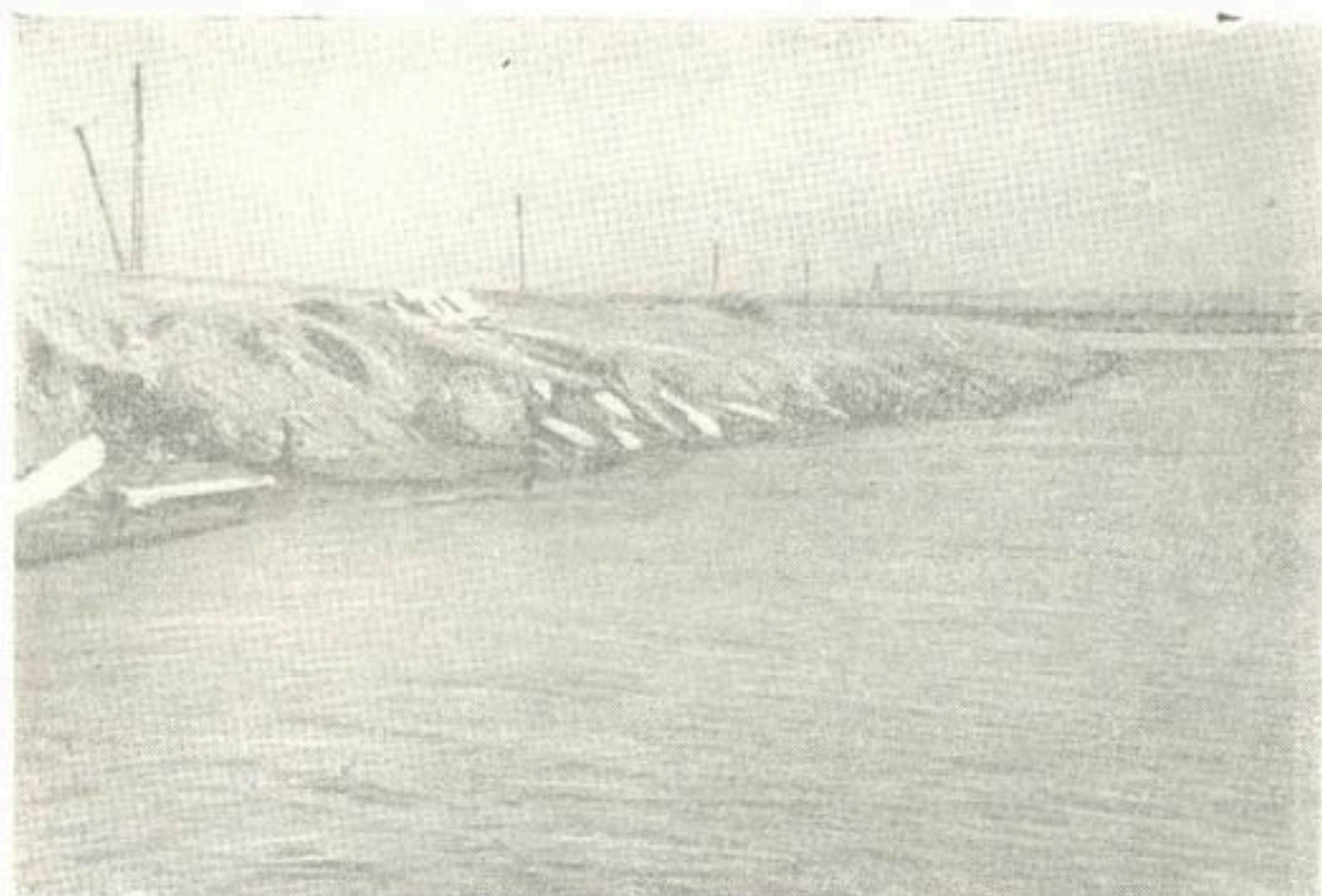
Рис. 5. Кайраккумское водохранилище; вид разрушенного крепления поселковой дамбы.
