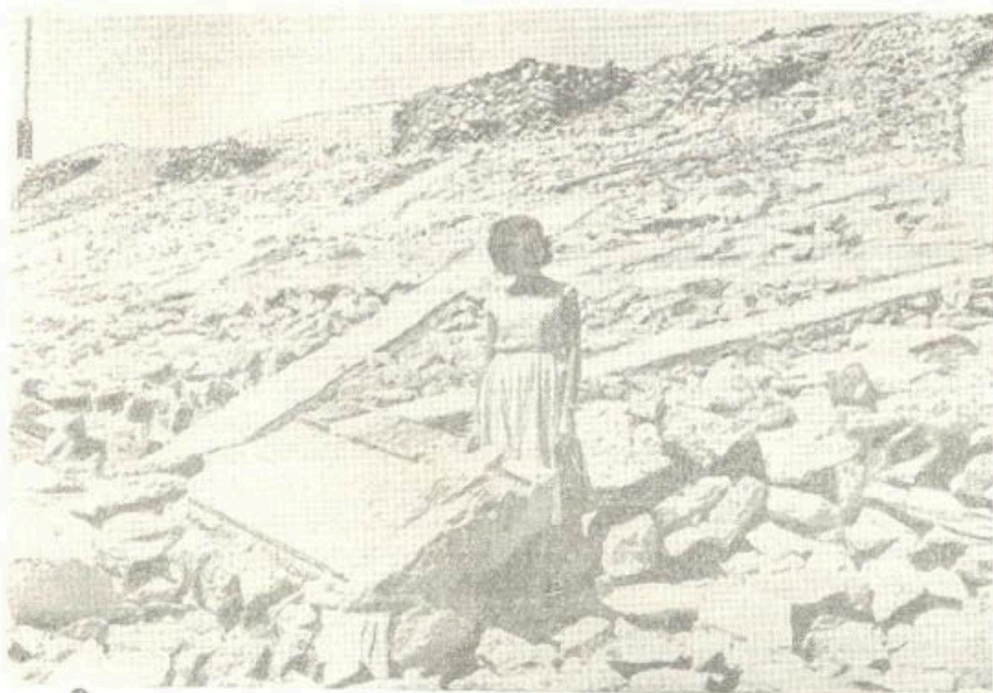
Рис. 2. Каттакурганское водохранилище; разрушение бетонного пояса крепления откоса плотины.
