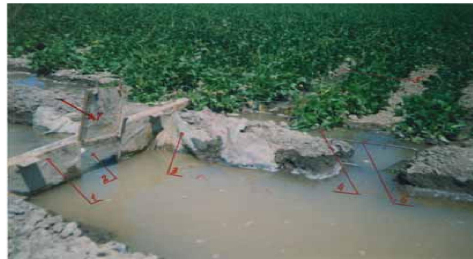
Фото 6. Жесткий, с регулирующим окном, перегораживающий подпорный щит
