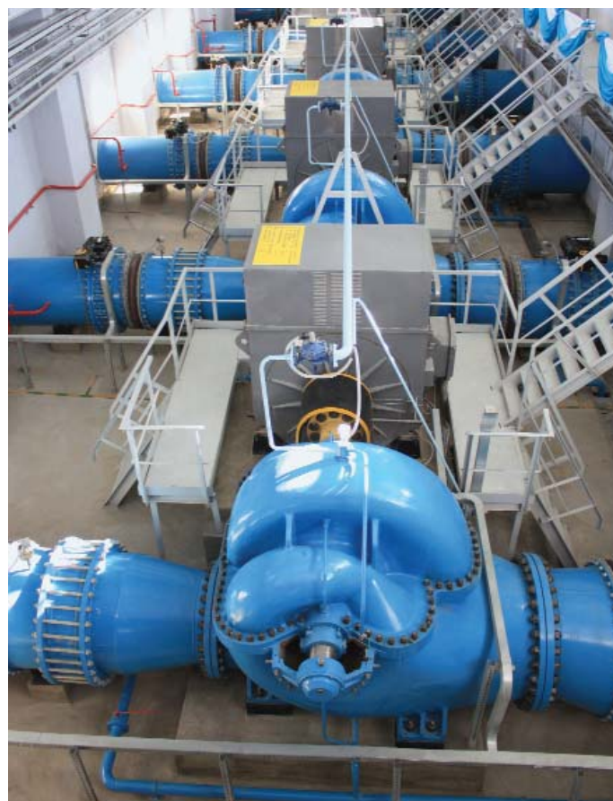
Машинный зал головной насосной станции машинного канала Иылгынагыз с насосными агрегатами Д 12500 - 10 М2
