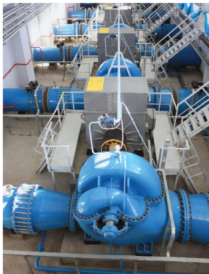
Машинный зал головной насосной станции машинного канала Илгынагыз с насосными агрегатами Д 12500 - 10 М2
