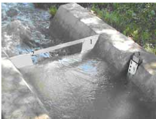
а) Гидропост с водосливом Чиполетти
