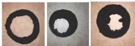
Рис. 1. Обрастание трубопроводов d = 40 мм различных лет эксплуатации
