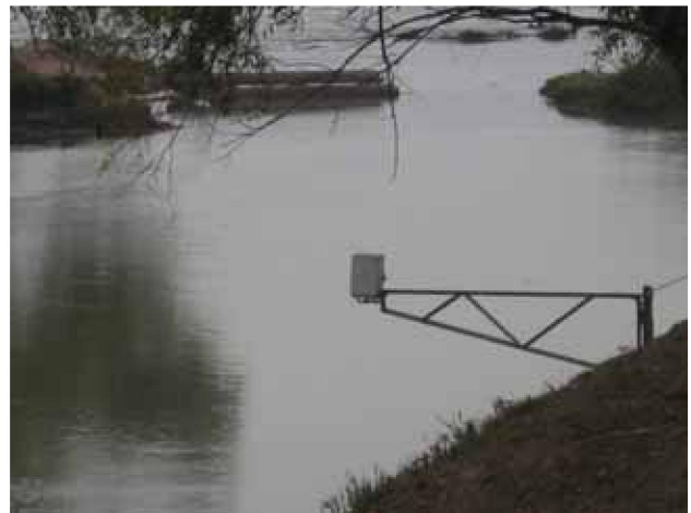
Рис. 4. Установка датчика уровня воды
