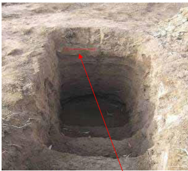
Фото 2.3 Уплотненная зона почвы
