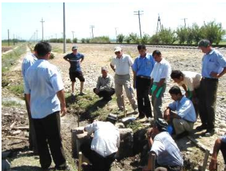
Рис. 5. Установка «ВЛС» заводского изготовления в створе гидрпоста
