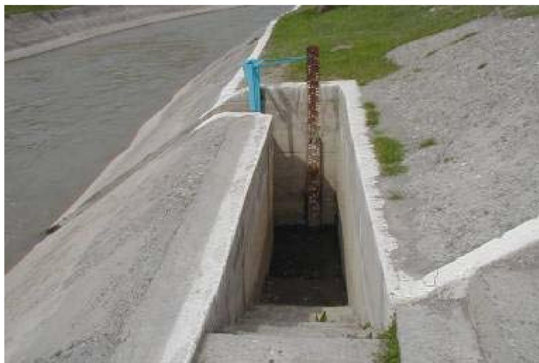
Рис.2. Успокоительный колодец с гидротехнической рейкой.
