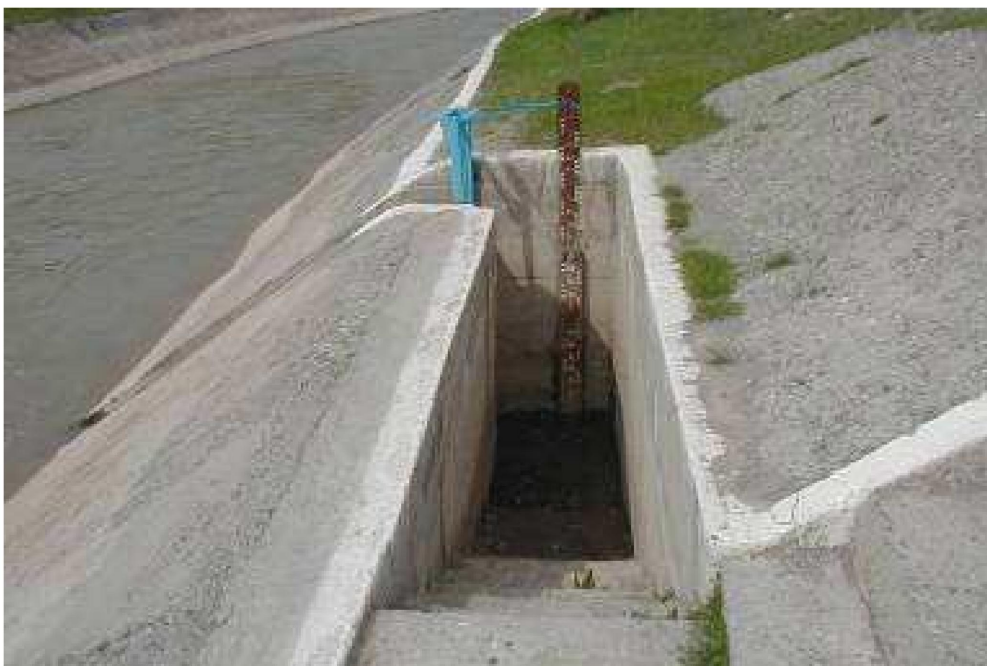
Рис. 3. Успокоительный колодец с гидротехнической рейкой
