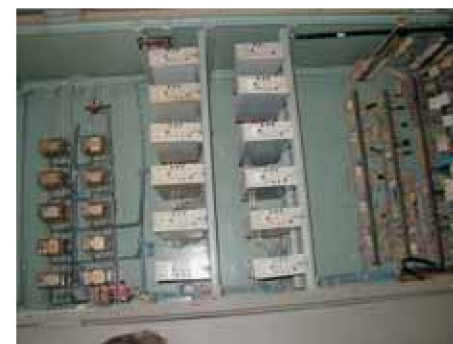
Рис. 3. Шкаф с преобразователями
