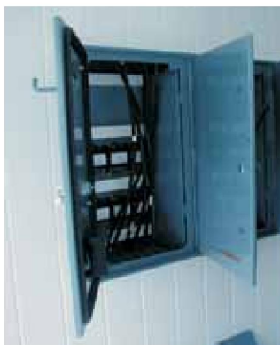
Рис. 4. Шкаф контроллеров с модулями ввода и вывода
