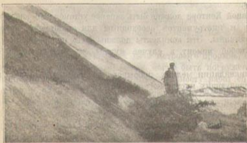
Фотогр. V. Разрушение бетонной облицовки и размыв под нею.
