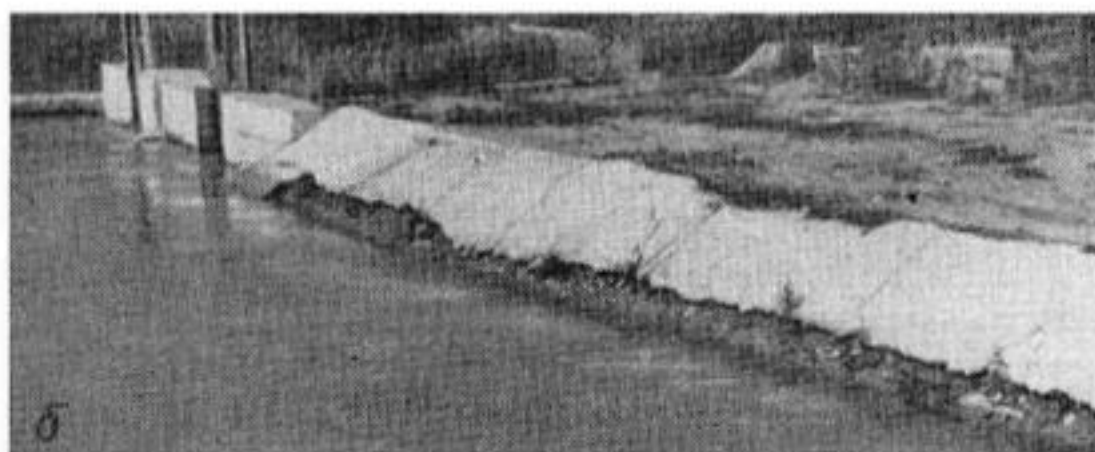
Рис. 22. Деформации монолитных облицовок каналов: а — поперечные и продольные трещины; б — осадка и сползание в нижней части облицовки.
