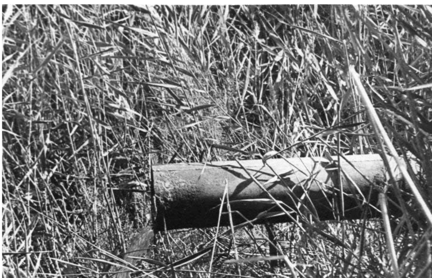
Рис. 2.5. Устьевые сооружения дрен, часто повреждаемые при очистке коллекторов от наносов и растительности
