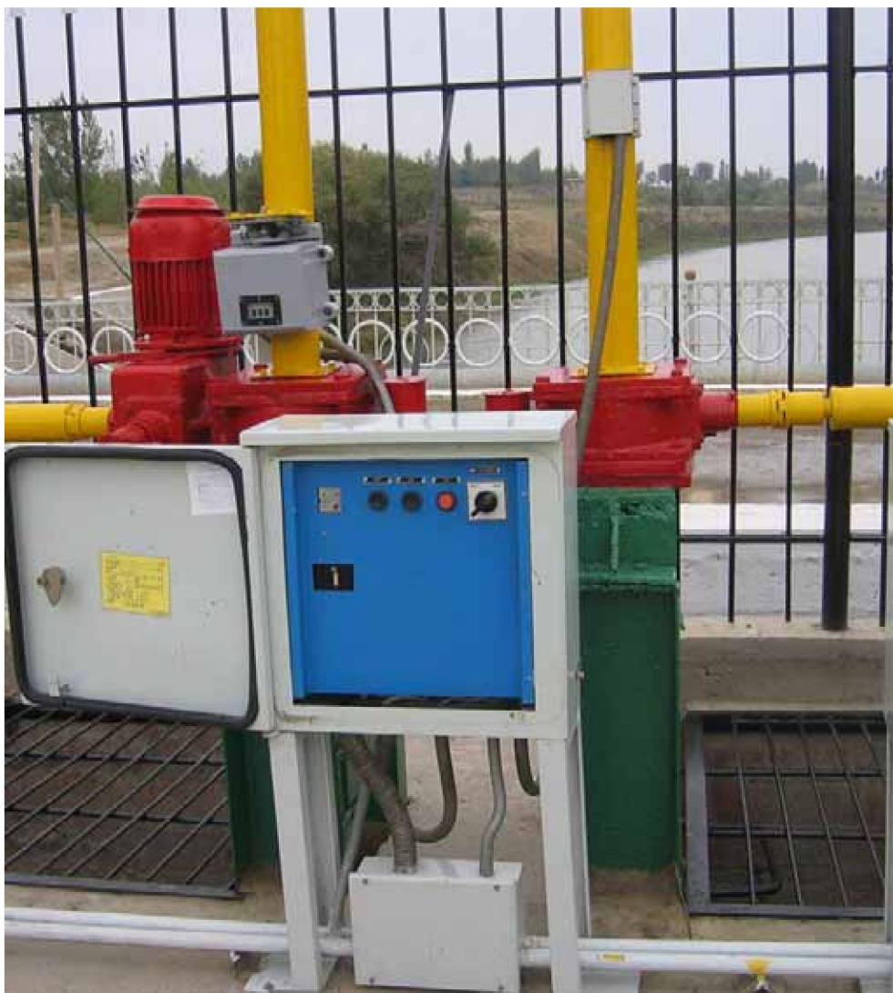
Рис. 5. Шкаф управления затворами
