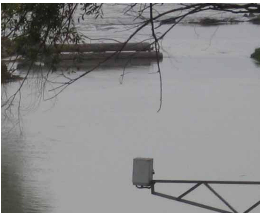
Рис. 2. Установка датчика уровня воды
