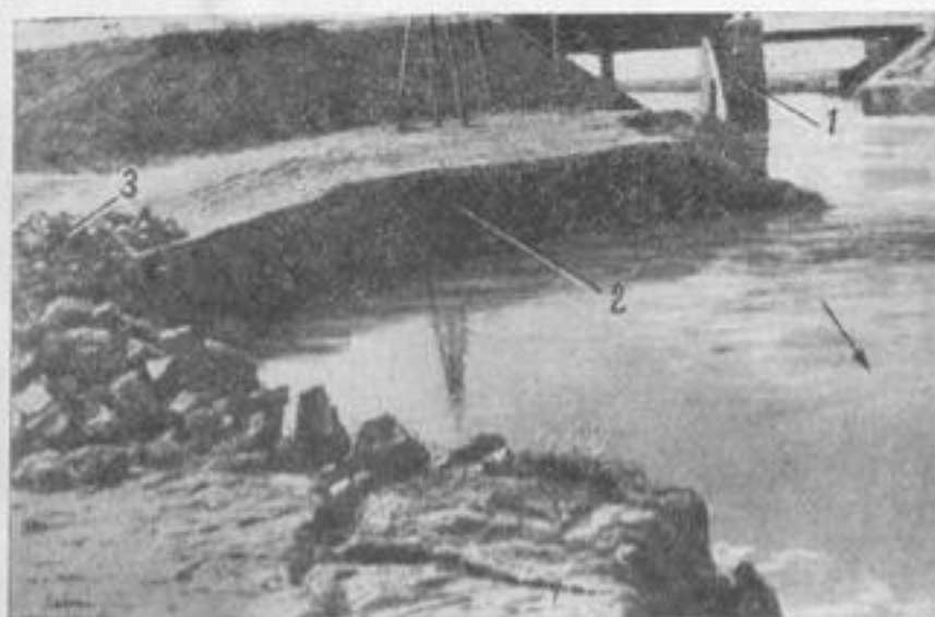
Рис. 2. Размыв правого берега Каракумского канала в нижнем бьефе за мостовым переходом:
