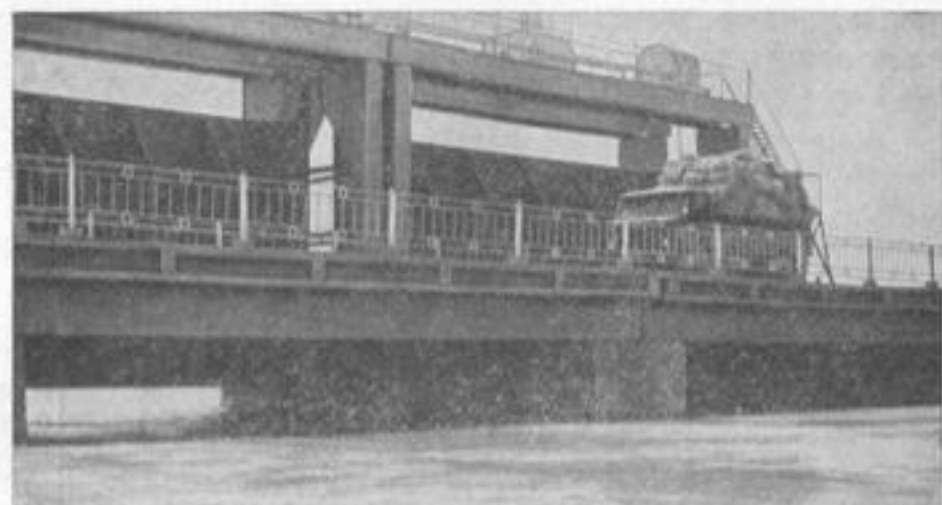
Рис. 27. Перегораживающее сооружение на Каракумском канале. построены дополнительные водопропускные сооружения.
