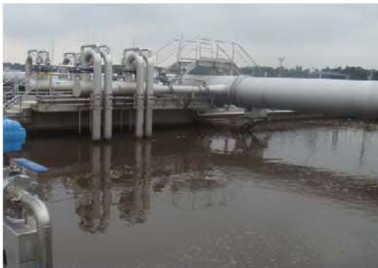
Фото 6.1. Очистные сооружения сточных вод г. Варшавы (Польша)
