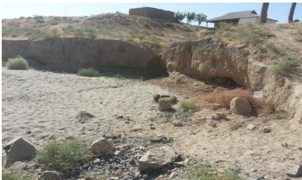
Рисунок 2 – Деформационные процессы за бетонированной частью подводящего канала.
