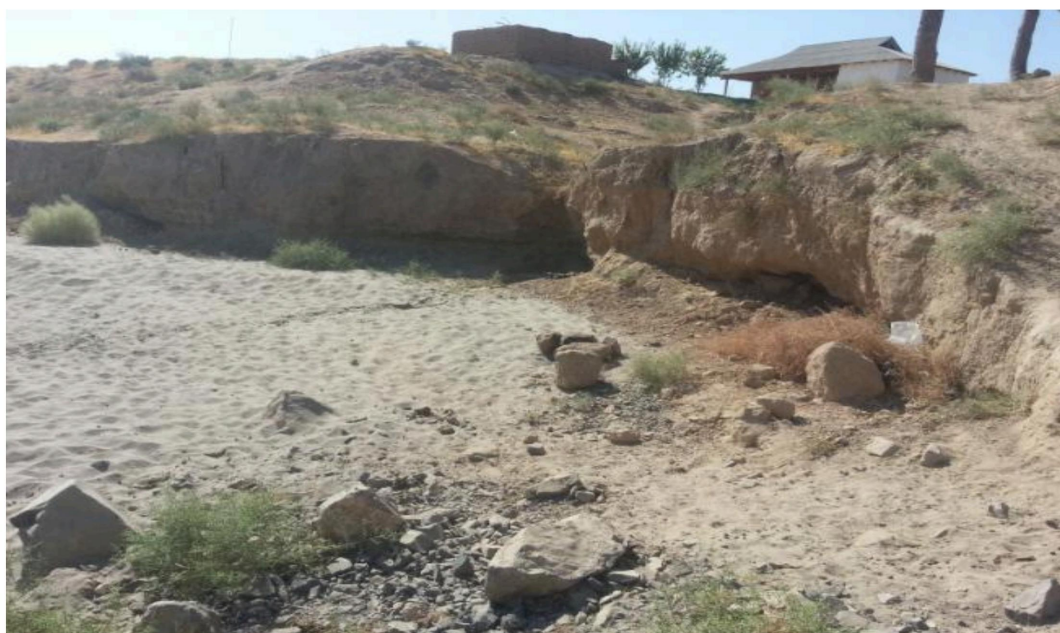
Рисунок 2 – Деформационные процессы за бетонированной частью подводящего канала.
