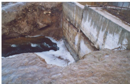
Рис. 1. Утечка воды через аварийное гидротехническое сооружение
