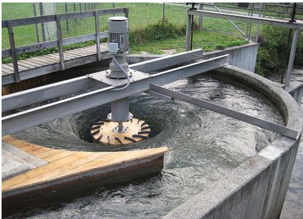
Рис.1 Водоворотная микро ГЭС
